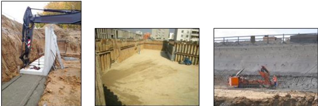
Abb. 3 links: Gewichtsstützwand als Winkelstützwand im Bauzustand (Foto: BlumeHaus 8 ) Mitte: Baugrubenverbau als einfach rückverankerte Stahlspundwand mit Einspannung im Baugrund rechts: Bodenvernagelung als Stützbauwerk für die Herstellung eines Tunnelportals
